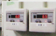
▲温度設定は荷捌エリアが+5℃～6℃で、冷凍庫は-23℃～-25℃
